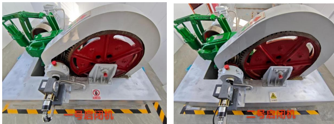
架河闸启闭机
