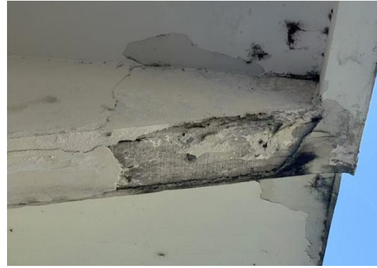
混凝土表层脱落
