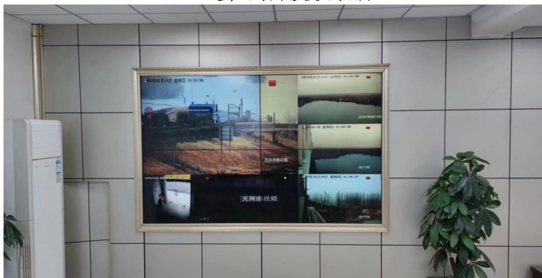
退洪闸视频监控系統缺失
